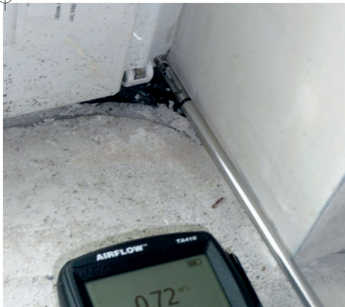
Najčastejšie opakovaná chyba – nevyriešený stavebný detail pripojenia okna ku stavebnej konštrukcii, v tomto prípade murovanej.
