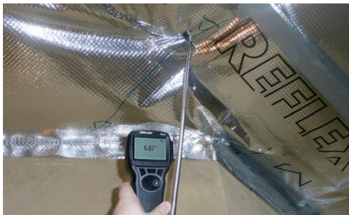
Nekvalitne vyhotovené parozábrany (pokrčenie a zvlnenie) majú za následok, že sa parozábrana nedá dokonale prilepiť k stavebnej konštrukcii.
